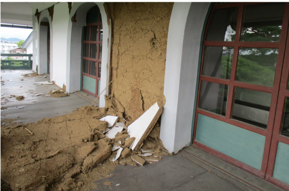
福島県沖地震で被災した開成館の様子(3階ベランダ)
