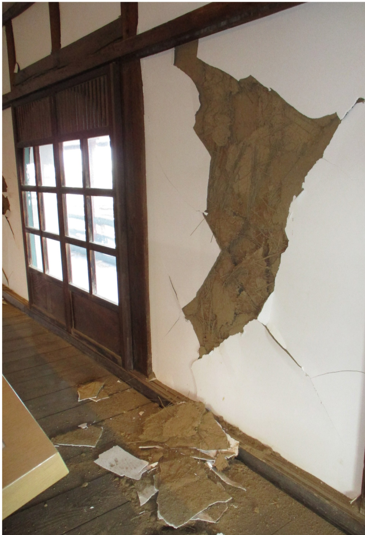
福島県沖地震で被災した開成館の様子(3階内部)
