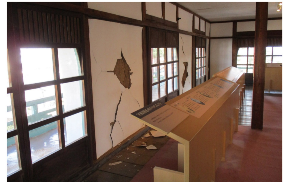
福島県沖地震で被災した開成館の様子(3階内部)
