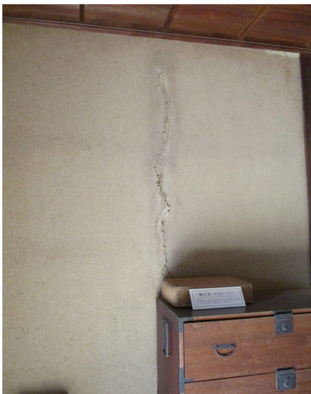
被災した安積開拓入植者住宅(旧坪内家)の様子(座敷)
