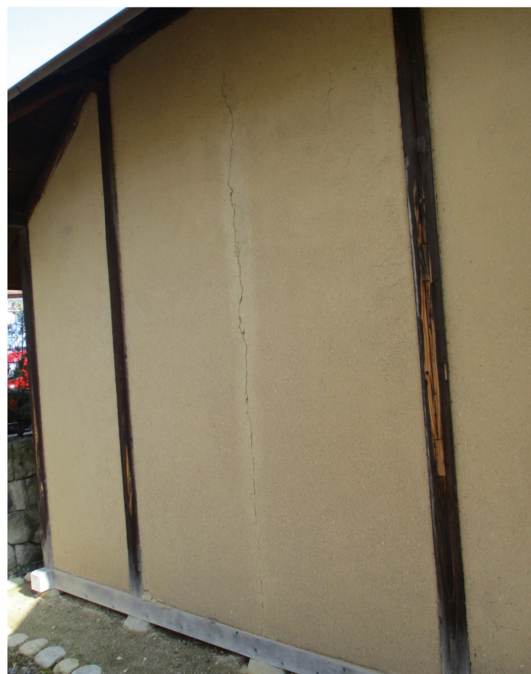
被災した安積開拓入植者住宅(旧坪内家)の様子(西側外壁)
